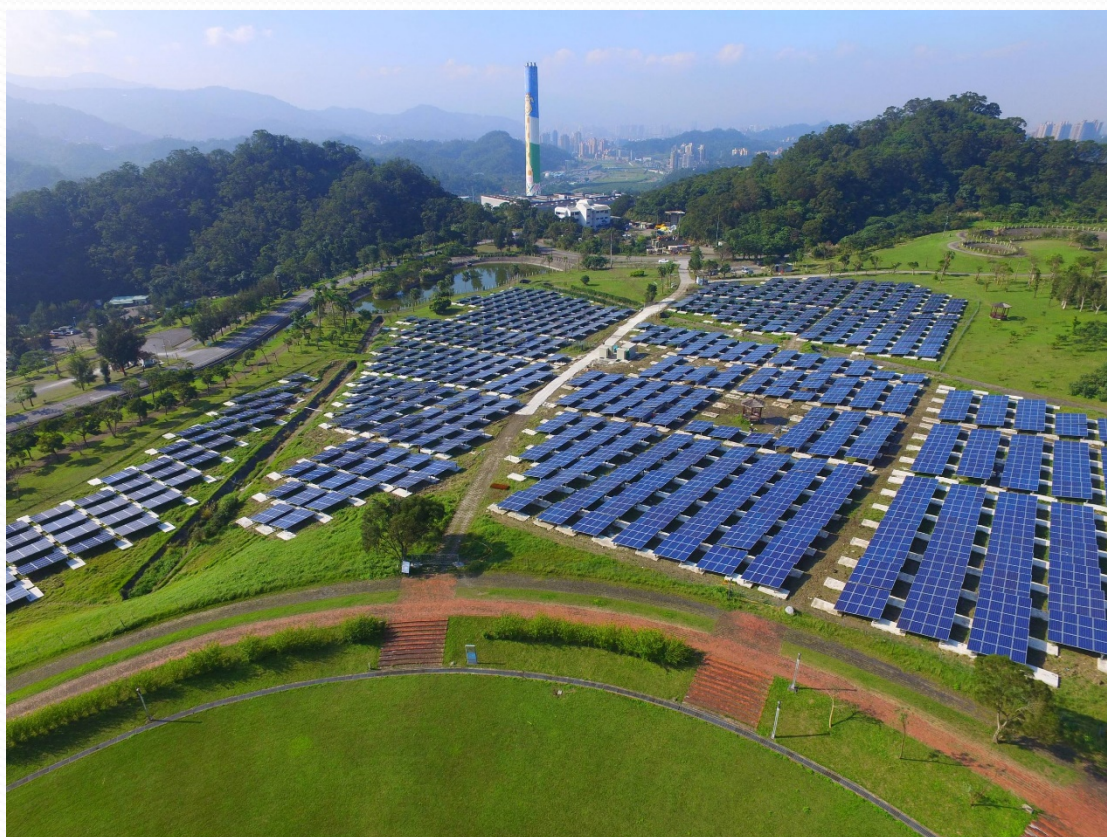
▲北臺灣最大地面型太陽光電(圖源:李茗家, 2017)
