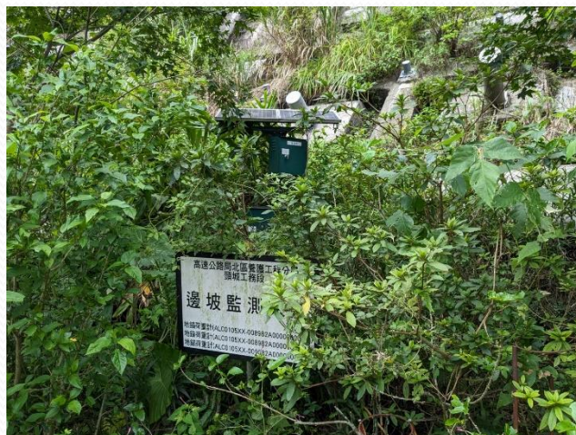
▲國五地錨自動監測站
