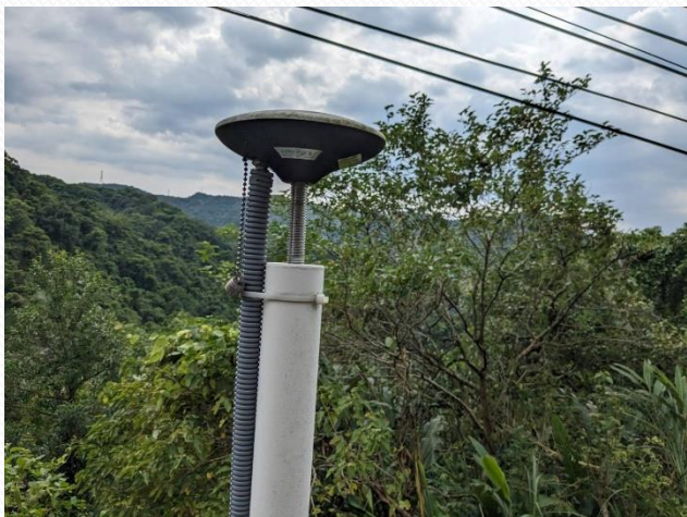
▲GNSS 地表位移監測設施
