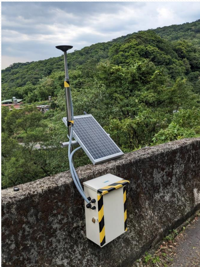
▲GNSS 地表位移監測設施
