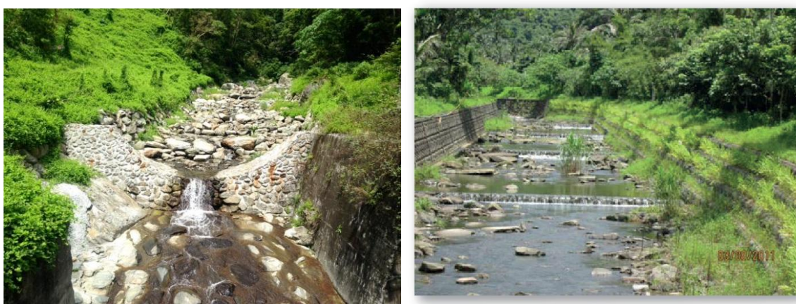
圖3-1-6 塊石混凝土壩及固床工 資料來源:農業部農村發展及水土保持署
