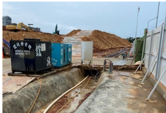
照片2 施工動線與臨時排水路衝突、擅自將局部梯形拍漿溝增設RC蓋版
