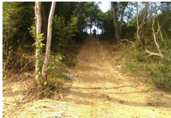
照片3 擅自增設施工便道
