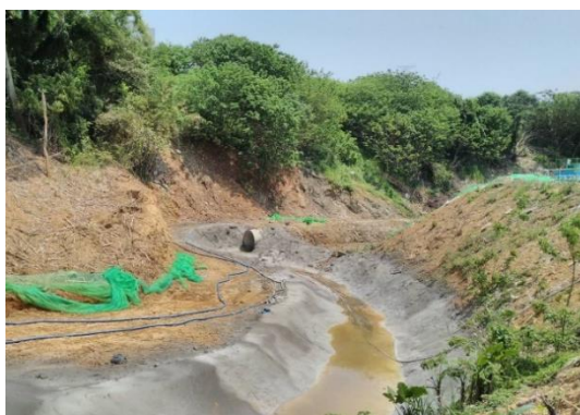
照片1 臨時排水路斷面、型式不符擅自將後段拍漿溝變更為RCP管涵
