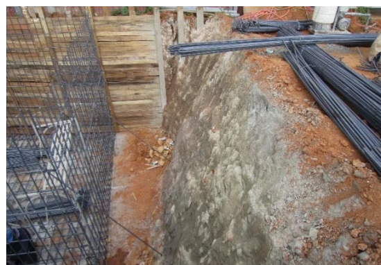
照片4 擅自將部份臨時性擋土措施鋼軌樁變更明挖斜坡及噴漿坡面
