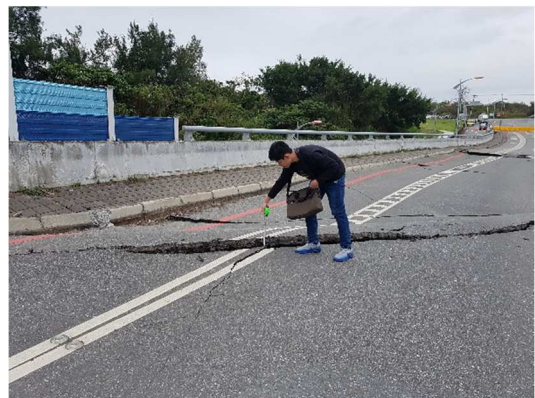
圖二、七星潭大橋橋面破裂狀況
